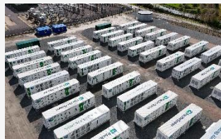
Projets de stockage d'énergie par batteries (BESS) de Sheaf Energy Park et Richborough Energy Park au Royaume-Uni.
