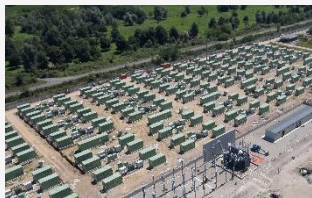
Enel Libra Flexsys, infrastructure de stockage d'énergie par batteries (BESS) située en Italie.
